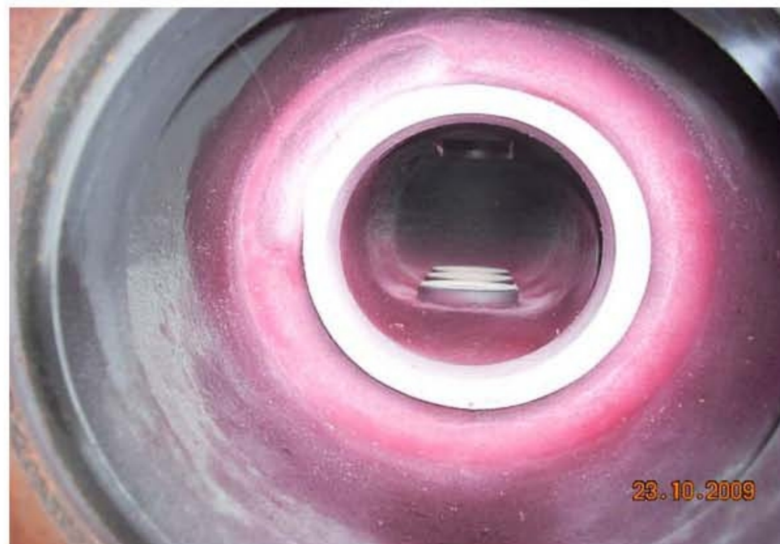
ภาพแสดง การตรวจสอบรอย CRACK บริเวณ VALVE SEAT ของ STOP VALVE ด้วยวิธี PENETRANT TESING ไม่พบรอย CRACK
