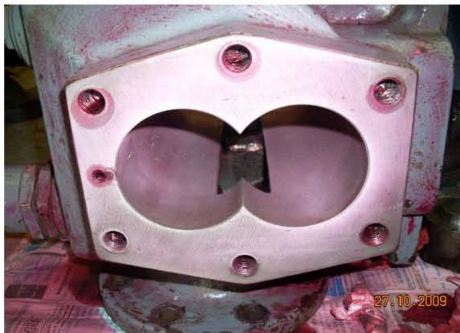
ภาพแสดง การตรวจสอบรอย CRACK ชุด MAIN OIL PUMP CASING ไม่พบรอย CRACK
