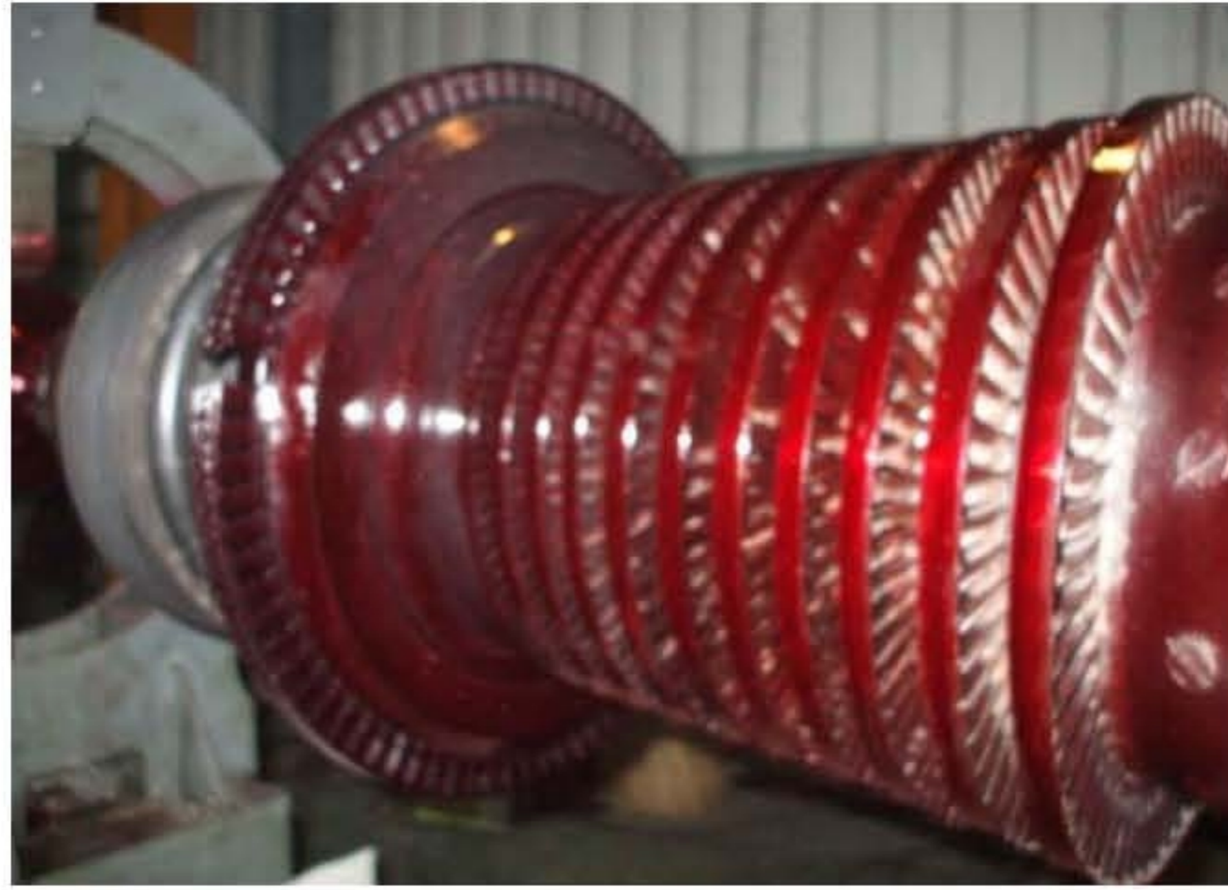
ภาพแสดง การตรวจสอบรอย CRACK ที่ BLADE ของ STEAM TURBINE
