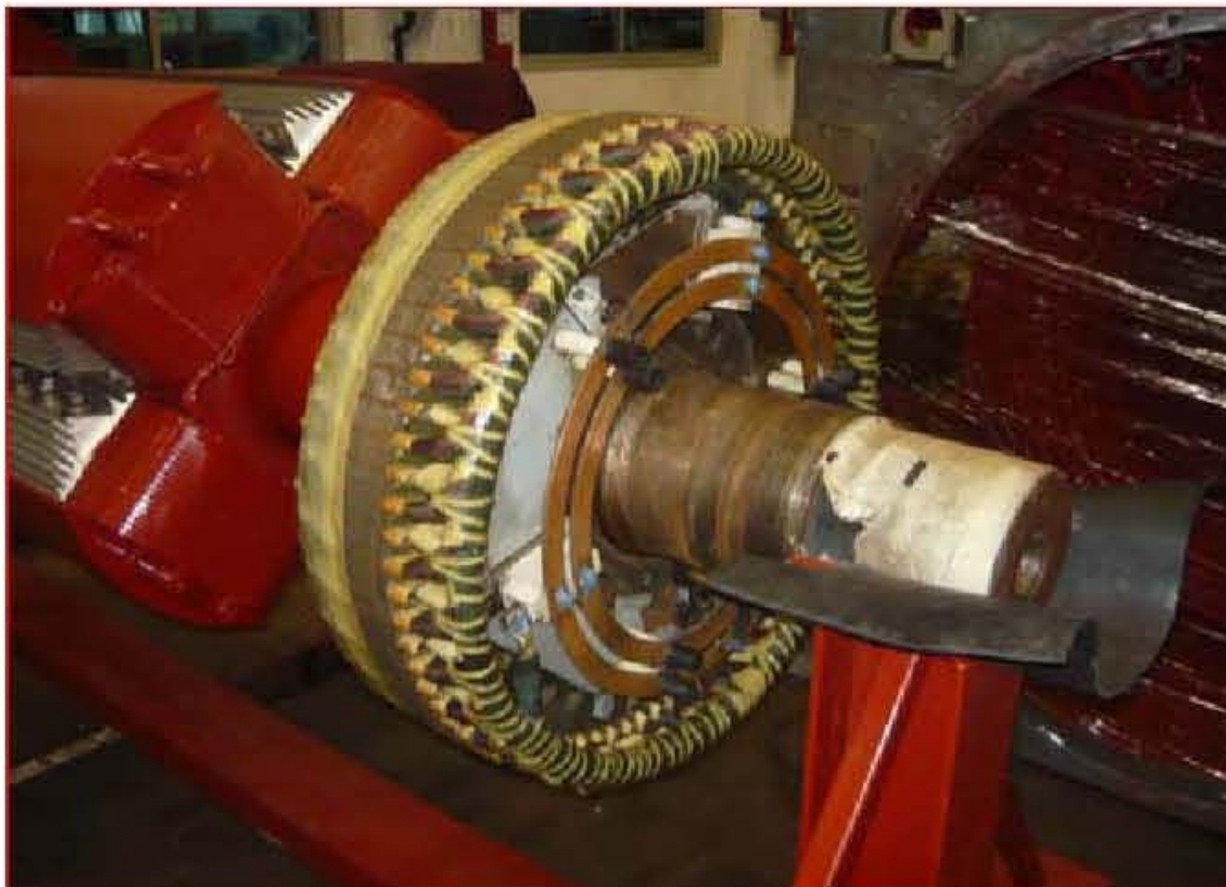
ภาพแสดง สภาพของ GENERATOR EXCITER
