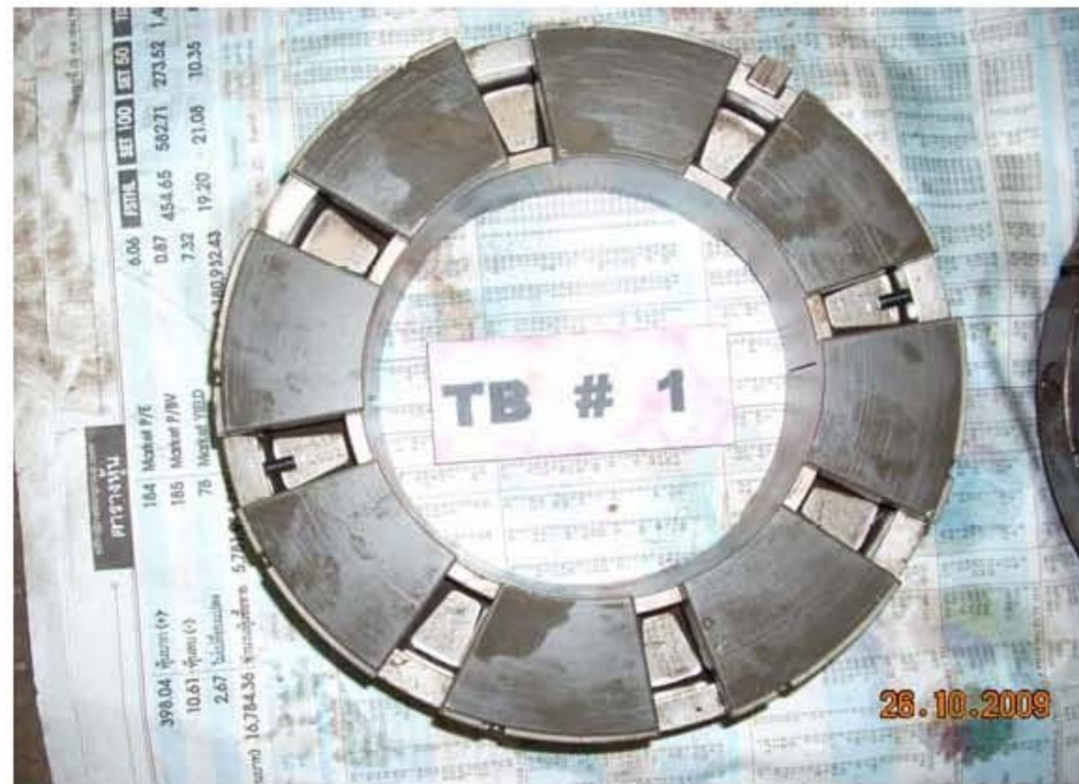
ภาพแสดง สภาพของ THRUST BEARING PADS ของ STEAM TURBINE ด้าน ACTIVE SIDE
