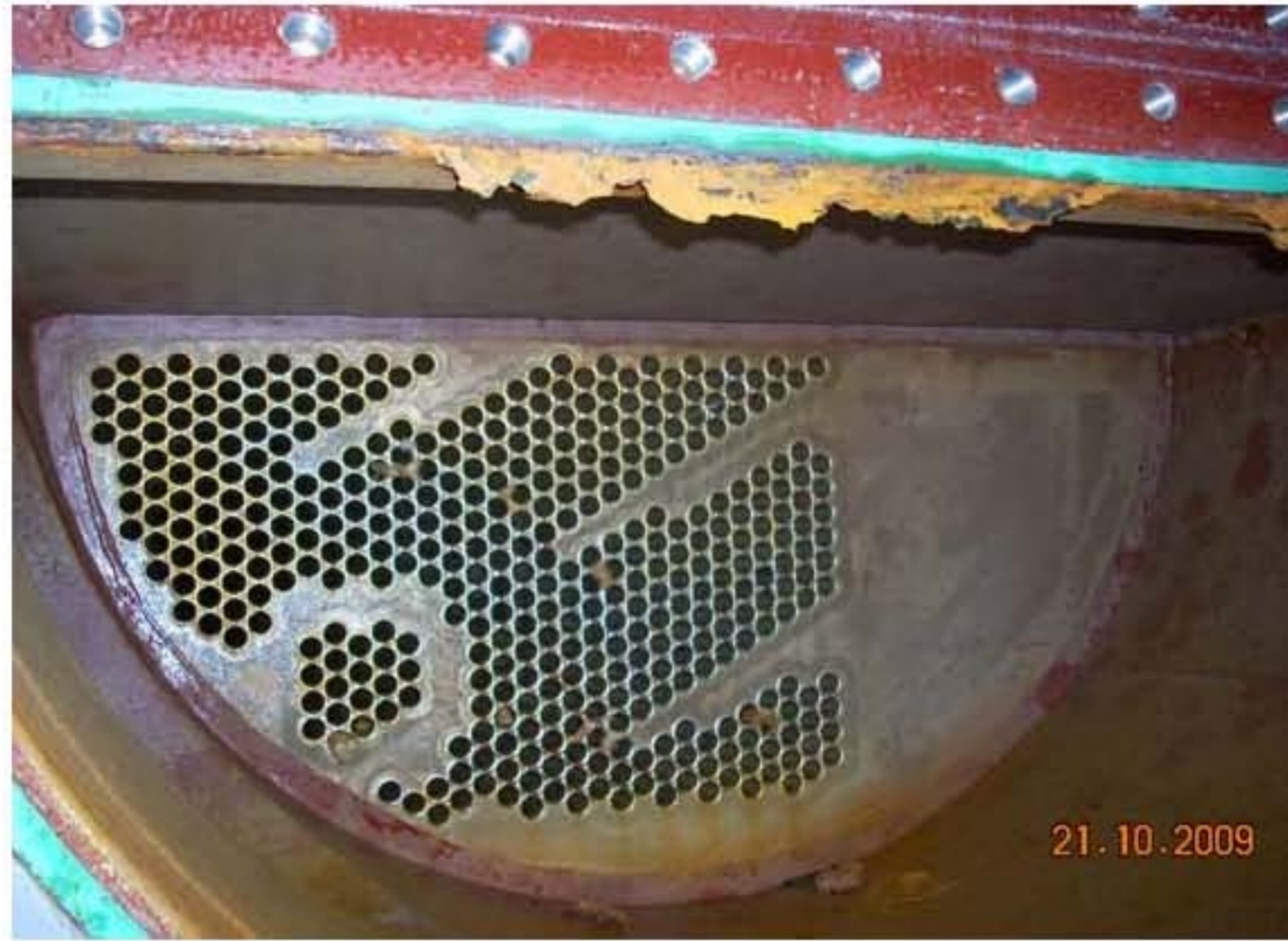
ภาพแสดง สภาพของ CONDENSER ก่อนทำความสะอาด
