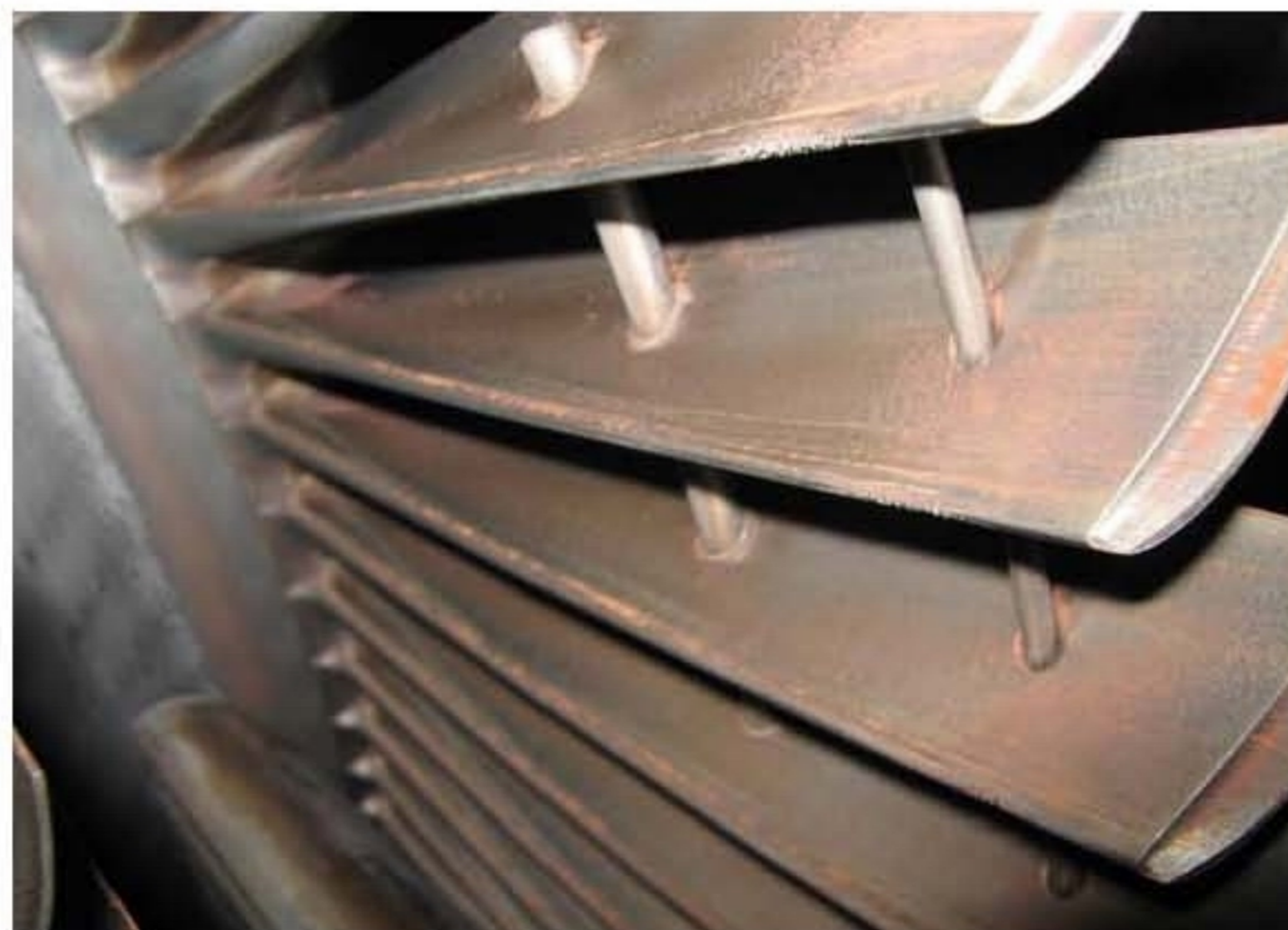
ภาพแสดง สภาพโดยทั่วไปของ TURBINE ROTOR พบการเกาะติดของคราบ STEAM
