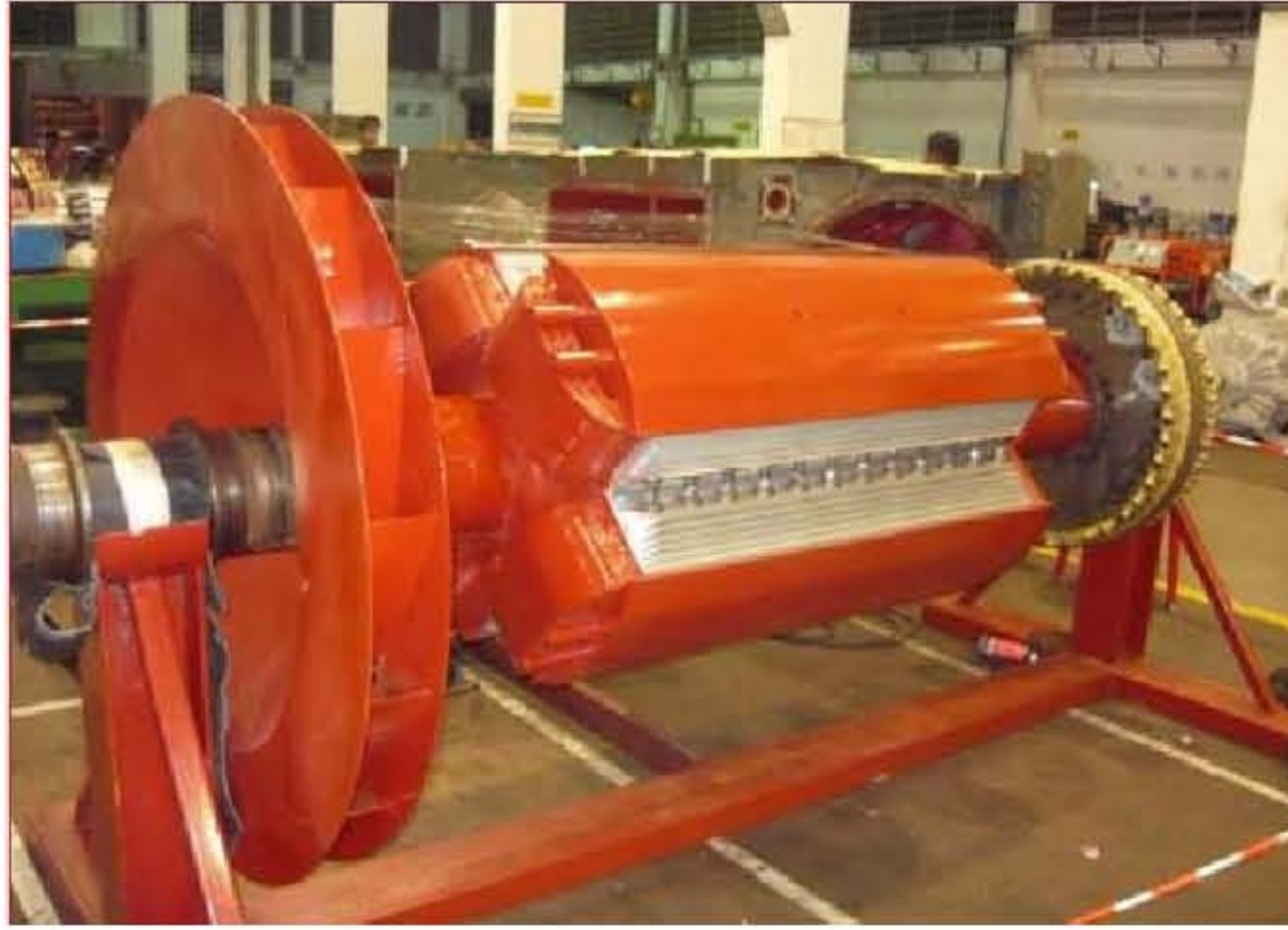
ภาพแสดง สภาพของ GENERATOR ROTOR
