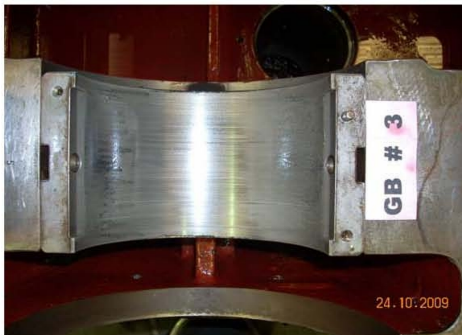
ภาพแสดง สภาพของ LOWER HALF ของ REDUCTION GEAR LOW SPEED SHAFT BEARING TURBINE SIDE
