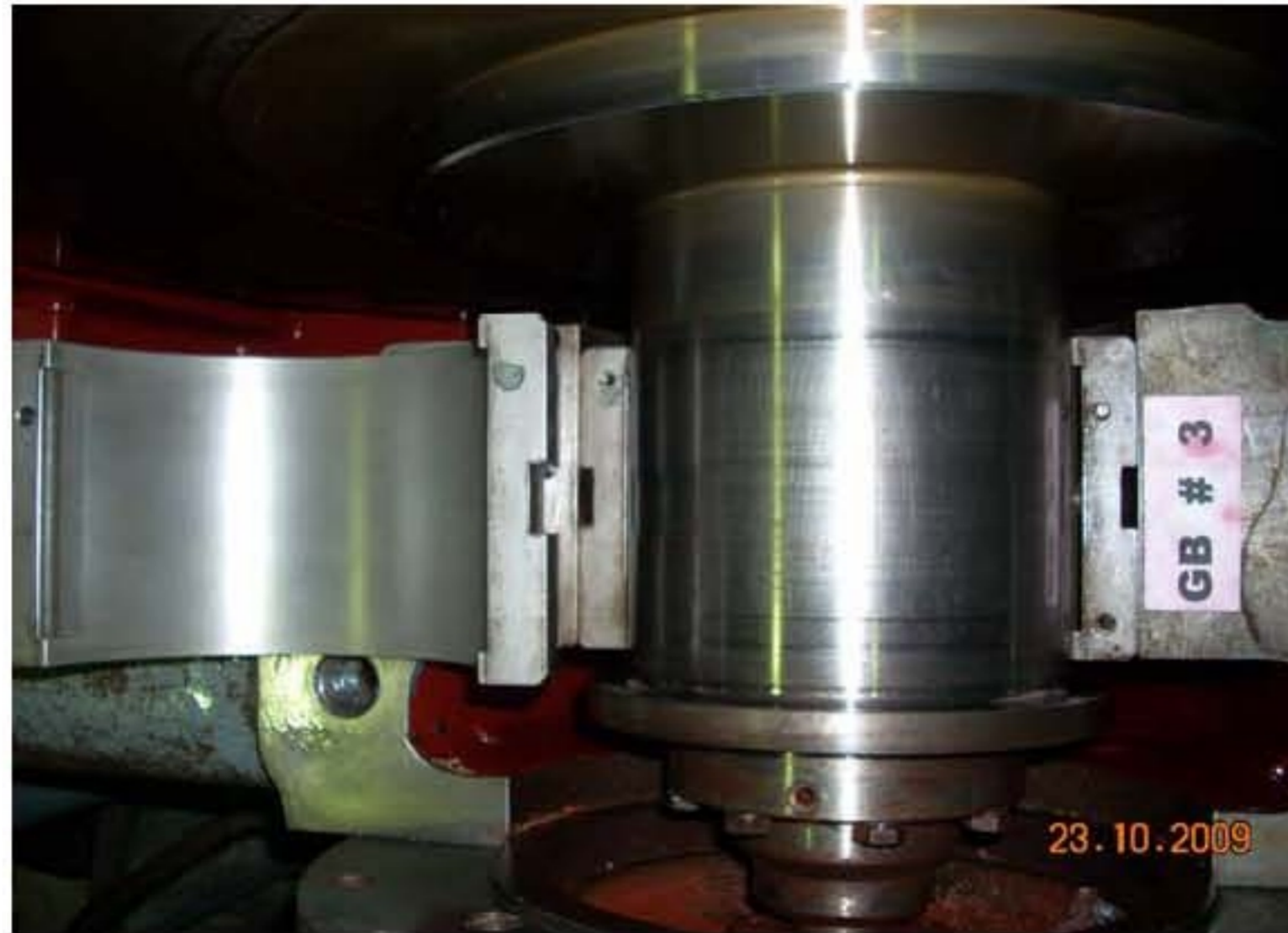
ภาพแสดง สภาพของ UPPER HALF ของ REDUCTION GEAR LOW SPEED SHAFT BEARING TURBINE SIDE
