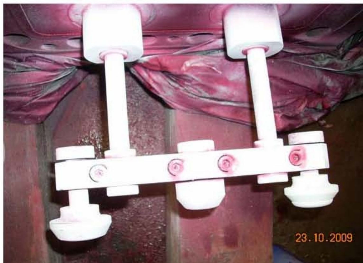
ภาพแสดง การตรวจสอบรอย CRACK บริเวณ VALVE CONE ด้วยวิธี PENETRANT TESING ไม่พบรอย CRACK
